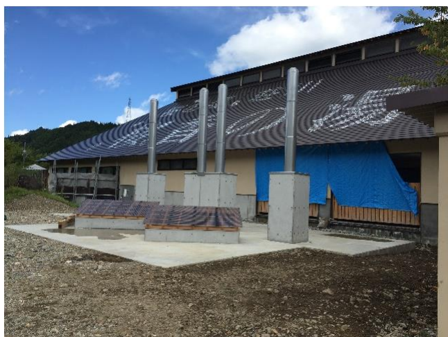
地下室に設置されたボイラー施設の建屋外観 手前の2つの片屋根はチップ挿入口。奥はボイラーの煙突
