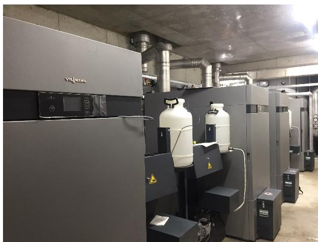
地下室に設置されたボイラー
